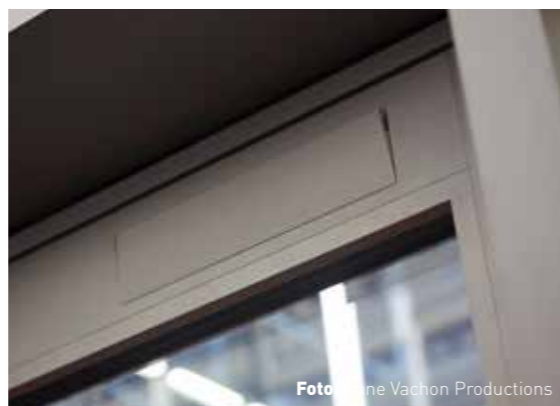
Tampa de acesso para manutenção.
